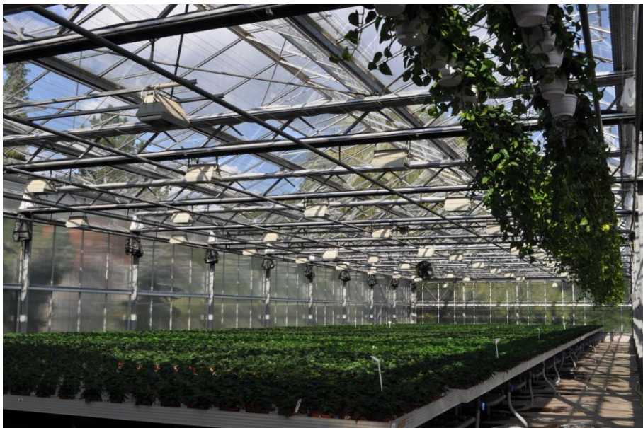
Foto 4: Ohne Zusatzlicht geht es nicht. Das Blockheizkraftwerk liefert dafür den Strom und versorgt den Betrieb mit Wärme. (EP/Peter Springer)
