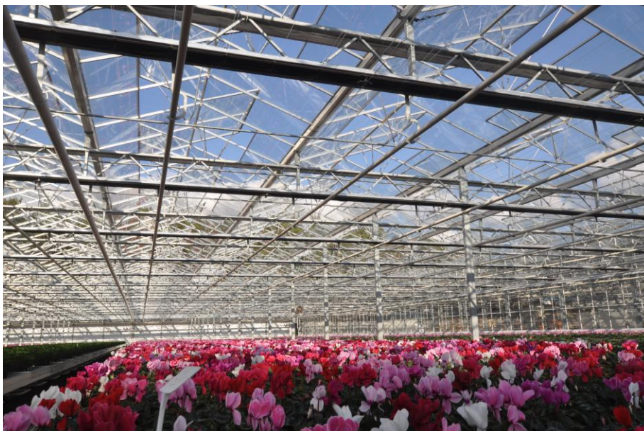
Foto 2: Der doppelte Energieschirm trägt wesentlich zur Verringerung von Wärmeverlusten bei. (EP/Peter Springer)
